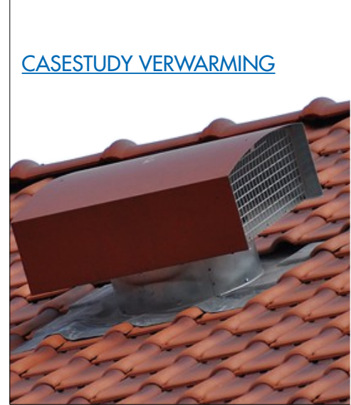
Ventilatirooster met loodslab
