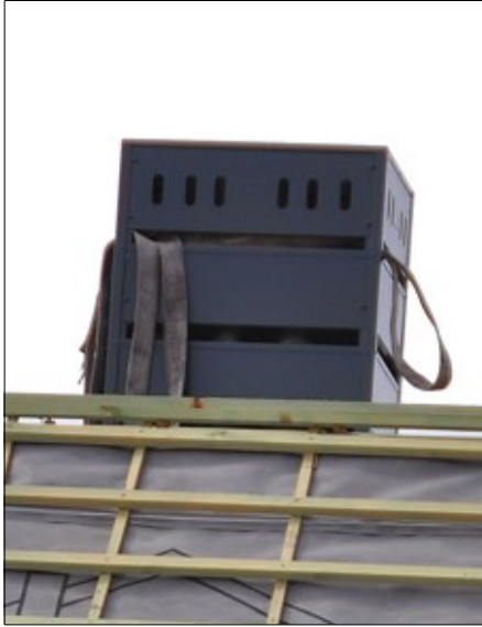
Kombitube, met werkraan geplaatst
