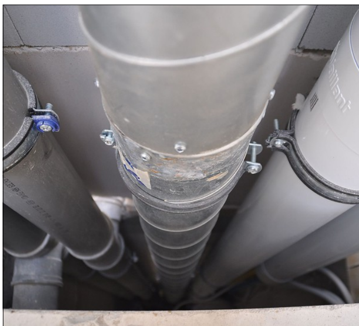
Via een schacht worden alle leidingen met af te voeren lucht naar het systeem gelooft
